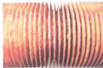
Obr. 21 – korozní vrstva mezi žebry
